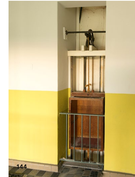
Handmatig te bedienen goederenlift in een portiekflat aan de Dominee Bechtlaan in Monnikenhuizen.
